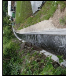
老朽化した用水路の整備・更新
